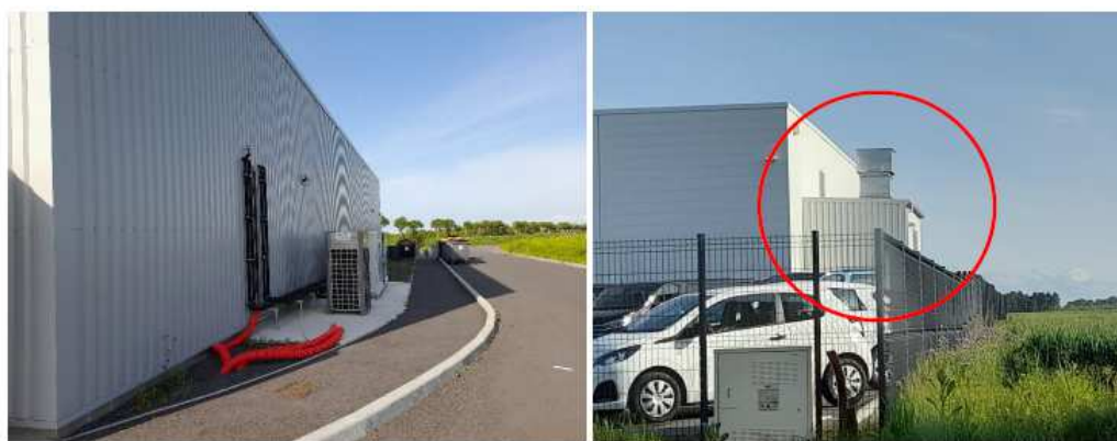
Figure 3 : Groupes froids du centre commercial (à gauche) et extracteur d'une cabine de peinture du concessionnaire automobile (à droite)
